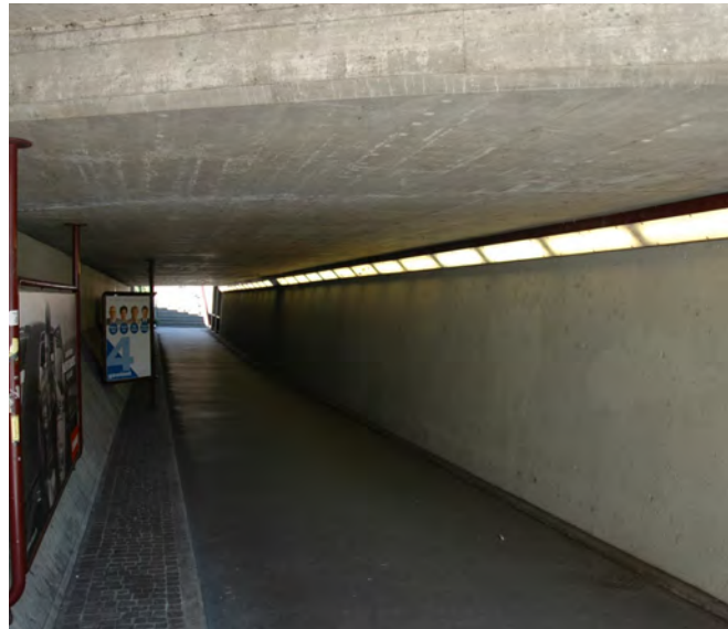
Personenunterführung Nord: Mindestausleuchtung, unübersichtliche Raum- und Eingangssituation (-)
