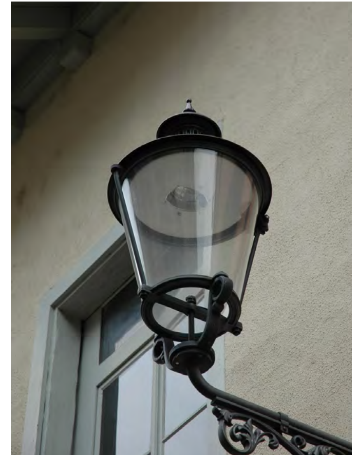
Umgrüstete Altstadtleuchte mit Reflektor
