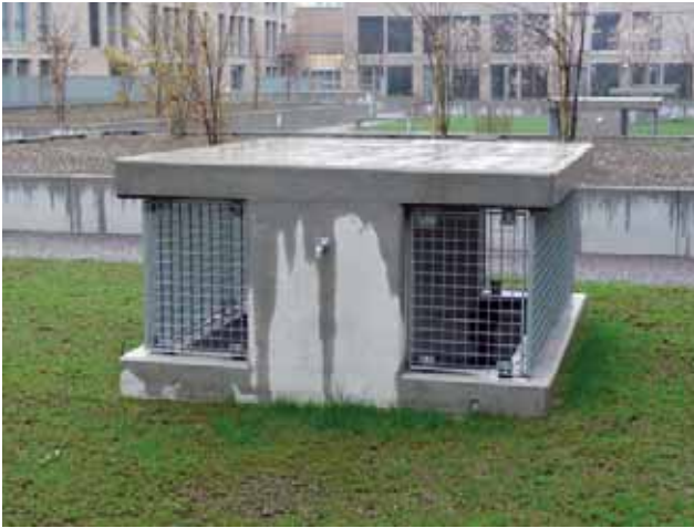
Abbildung 24a/b Öffnungen für die natürliche Lüftung der Fahrzeugeinstellhalle.
