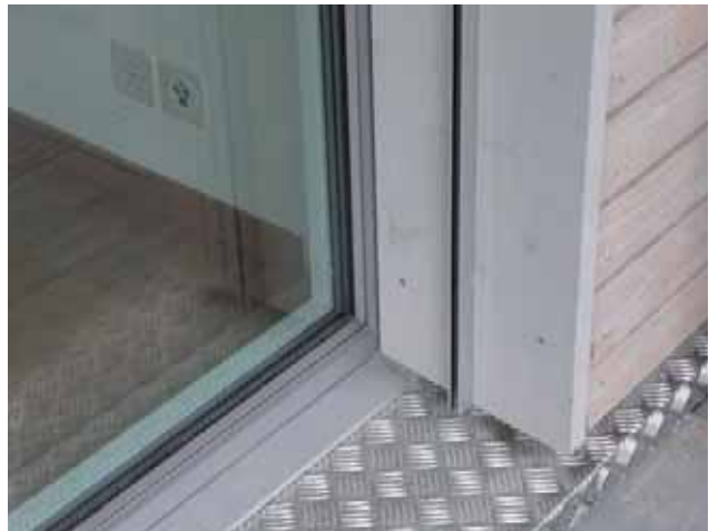
Abbildung 43 Fensterleibung mit Alu-Abdeckung.
