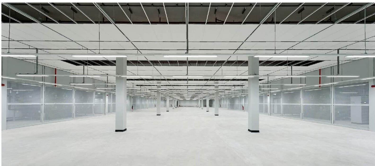
Blick ins Allerheiligste: In diesem Raum in Hegi stehen bald die Serverschränke. Durch die Gitterwände links und rechts wird dann Frischluft in den Raum gepustet. Foto: PD
