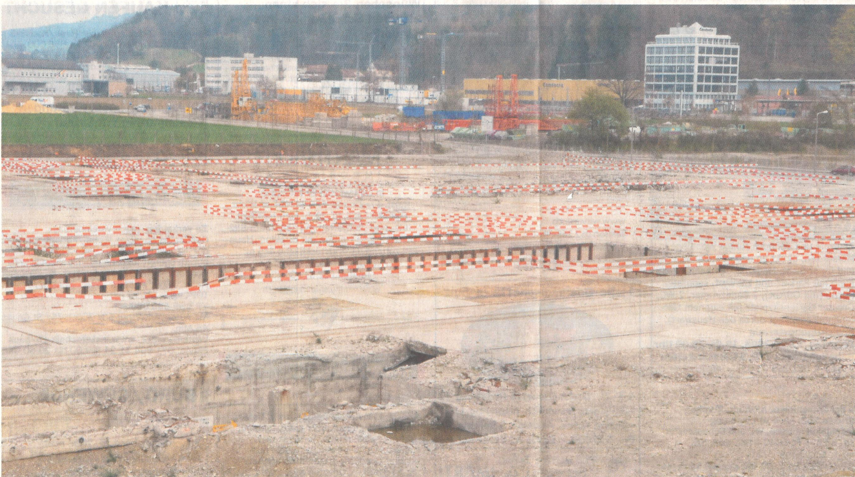
Auf dem ehemaligen Gelände der Sulzer-Giesserei in Oberwinterthur wollen Investoren in den nächsten drei Jahren 400 Wohnungen bauen. Bild: Heinz Diener
