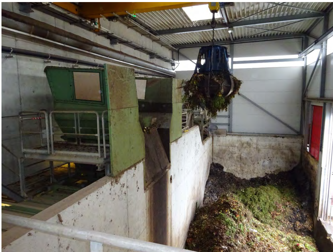
Abbildung 4: Tiefenbunker mit Krananlage (Foto: Ecosens)
