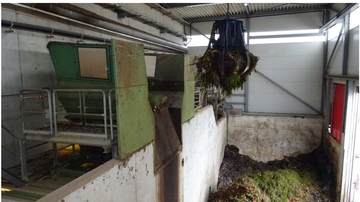
Bild 1: Tiefenbunker mit Krananlage (Foto: Ecosens)
