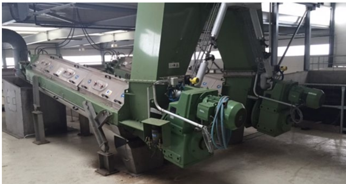
Abbildung 6: Schneckenpresse (Quelle: Prozessbeschrieb Kompogasanlage [8])
