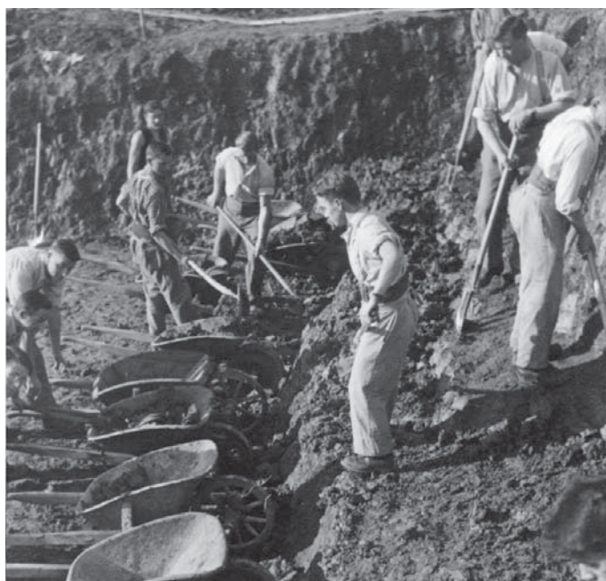
▲ Aushub für die Trotte der Landwirtschaftlichen Schule. Historische Aufnahme von 1939. | Foto: Landwirtschaftliche Schule Strickhof, Wülflingen
