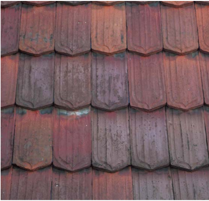
▲ Von Hand gestrichene Biberschwanzziegel. Sie dienen heute als Wetterschutz an einer Westwand eines Bauernhauses in Wülflingen. | Foto: Denkmalpflege Stadt Winterthur
