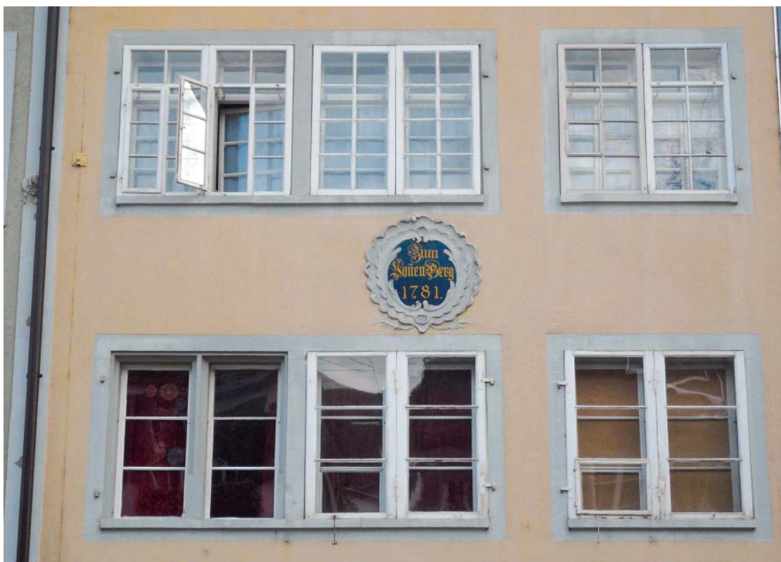
◀ Historische Fenster mit Vorfenstern an der Steinberggasse 41, «Haus zum Sonnenberg». Die alten Fenster tragen zum Charakter der Fassade und des Gassenzuges bei. Die feinen Profile und Sprossen zeugen von sorgfältigem Handwerk. Foto: Denkmalpflege Stadt Winterthur
