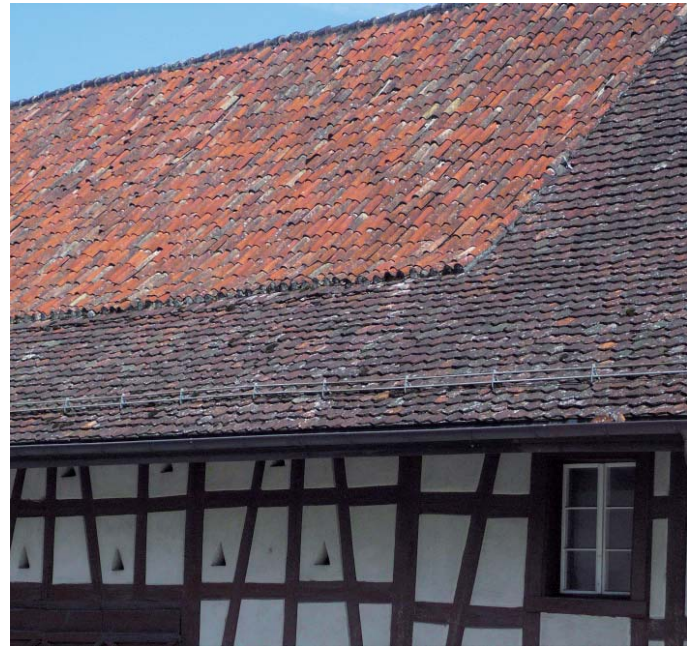
▲ Hohlziegel auf dem Dach eines Ökonomiebaus der Wespimühle. Diese Ziegelform geht bis ins Mittelalter zurück. | Foto: Denkmalpflege Stadt Winterthur
