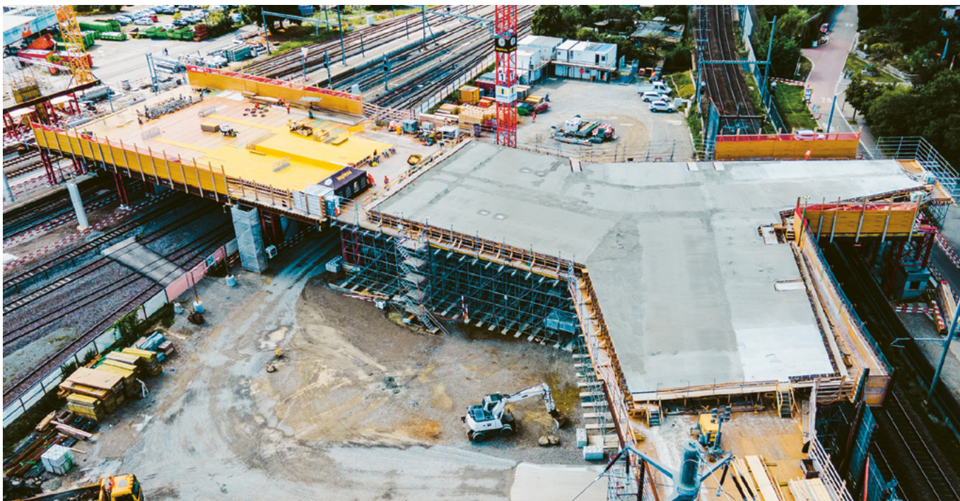
Die erste Etappe des Brückenkörpers: Am 11. und 12. September 2024 wurden 2600 Tonnen Beton verarbeitet.
