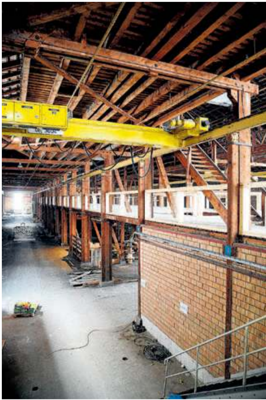
Die Halle bleibt unisoliert und unbeheizt, ausser den Einbauten (rechts). Bild: Marc Dahinden
