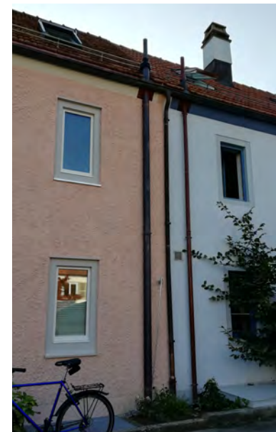
Abgasleitung links in Kupfer, rechts in Kunststoff
