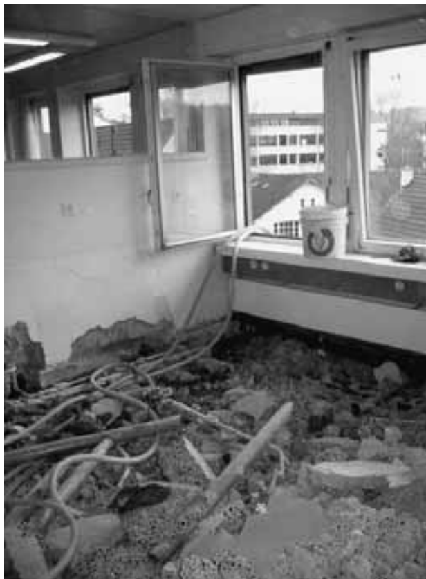
Ein Wasserschaden drohte die Schulzahnklinik lahm zu legen.
