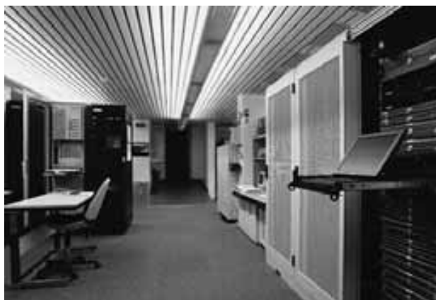
Blick ins Rechenzentrum
