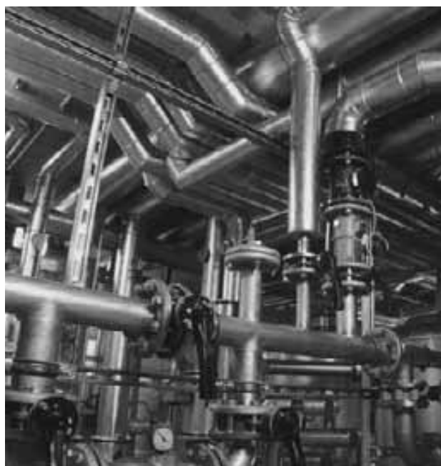
Eishalle Deutweg, Leitungsführung Kälteerzeugung
