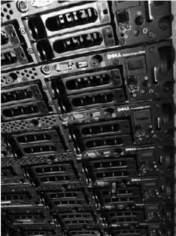
Blick in die Serverfarm im Rechenzentrum
