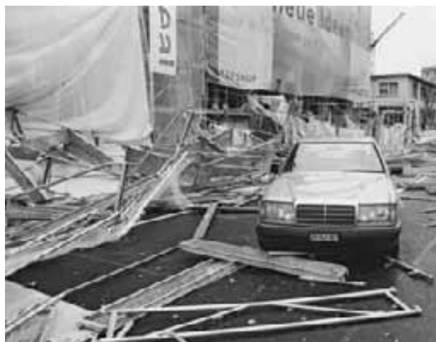
Ein Baugerüst an der Zürcherstrasse stürzte wegen Windböen auf die Fahrbahn
