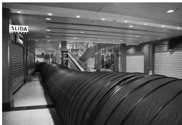
Brand im Einkaufszentrum Seen; Rauchgasmanagement mit Grosslüfter.
