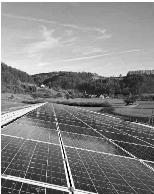
Stadtwerk Winterthur trug 2008 zur Förderung von Solarenergie bei: Fotovoltaikanlage auf dem Hof Ifang und Solardachaktion «100jetzt».
