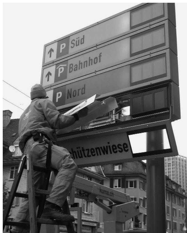
Installation des neuen Parkleitsystems
