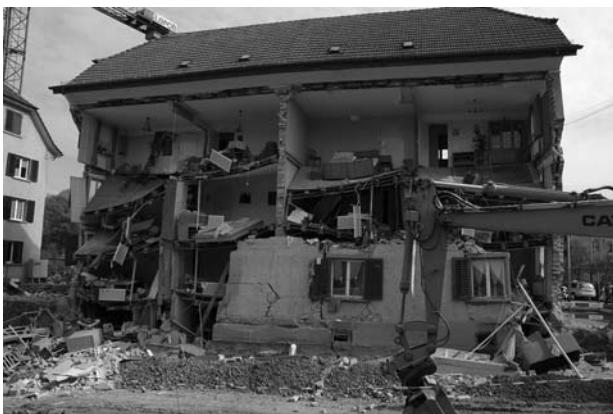
Fassadeneinsturz vom 29. April 2005 eines Mehrfamilienhauses an der Weststrasse.
