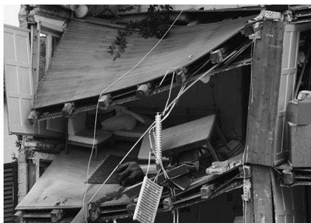
Grosseinsatz; Fassadeneinsturz an der Weststrasse
