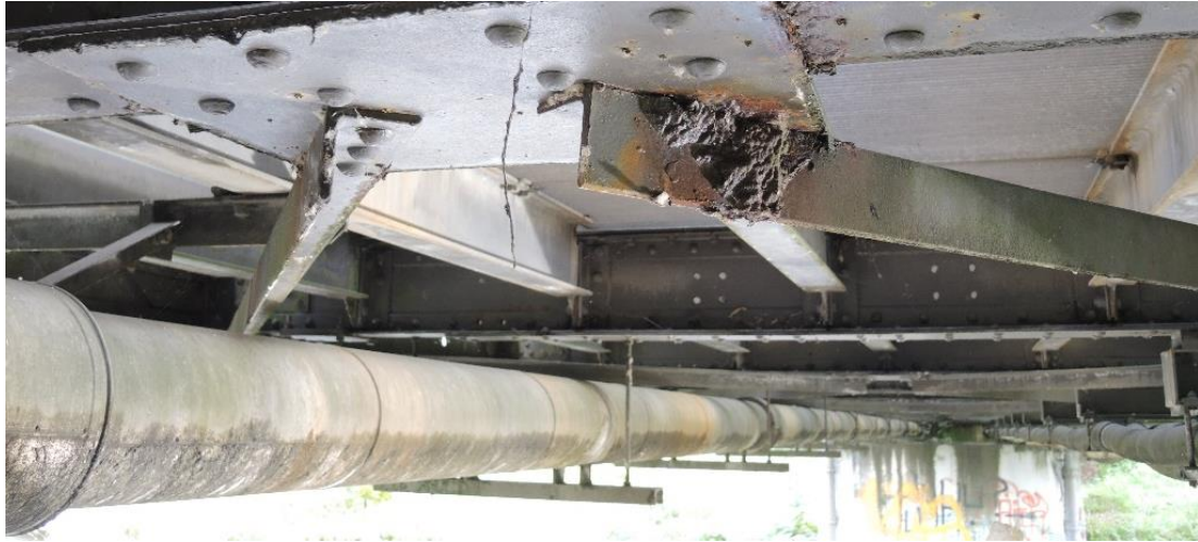
Abbildung 10 – Korrosion Kreuzverband Brückenuntersicht
