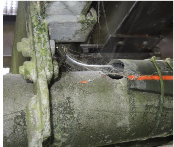
Abbildung 22 – Öffnung der Isolation der Elektroleitung, Achse A-A
