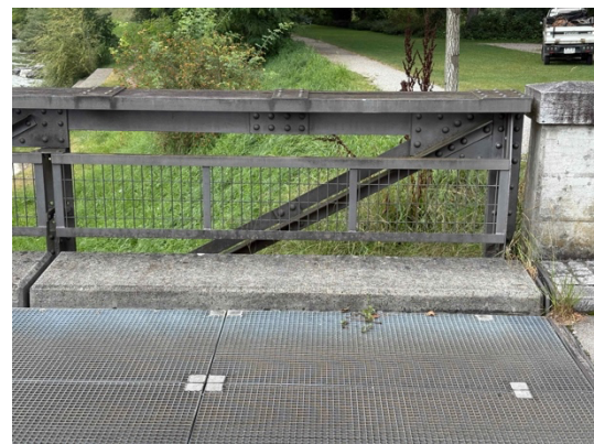
Bild 3: Absturzsicherung am Brückenanfang
