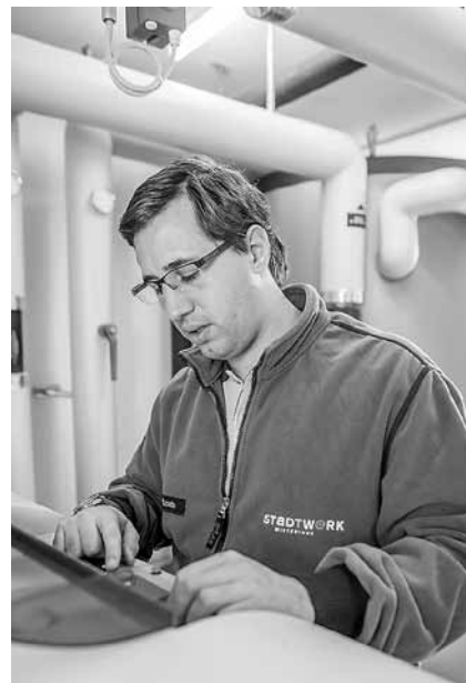
Stadtwerk Winterthur kümmert sich um die Wartung und den Betrieb von Wärmeanlagen, die im Energie-Contracting-Verfahren betrieben werden.
