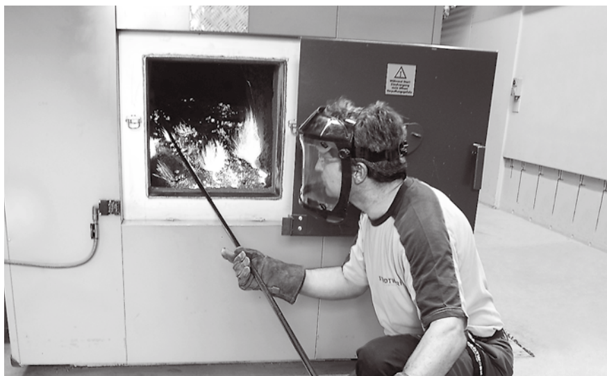
Stadtwerk Winterthur kümmert sich um den Betrieb und die Wartung der Energieanlagen.
